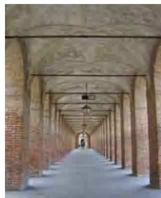
4 Volte a crociera con catene (tiranti) nel portico del palazzo-giardino di Sabbioneta (Mantova).
